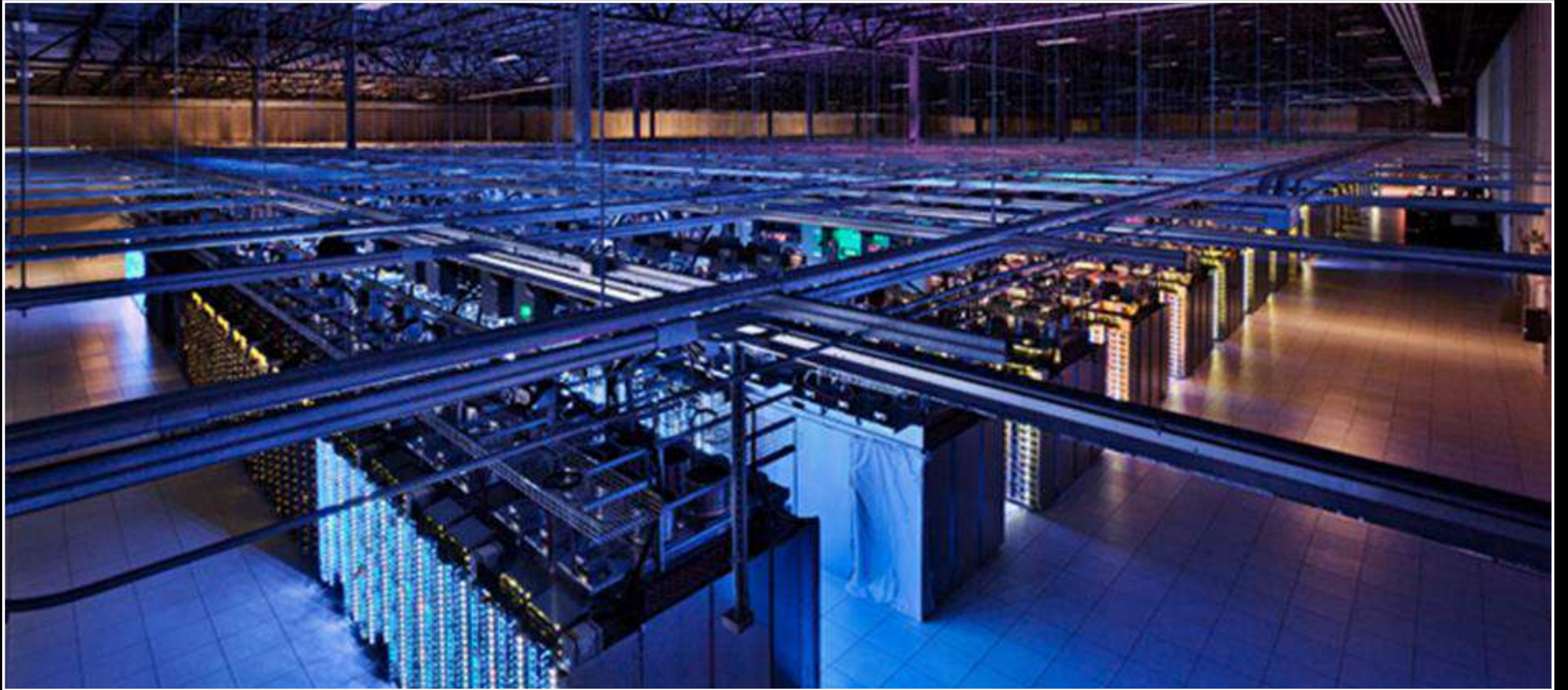
Vista interna di una Data Farm della Google
